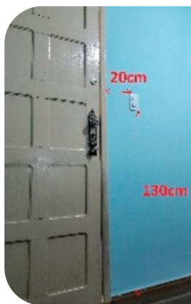
Interruptor instalado ao lado da maçaneta da porta
