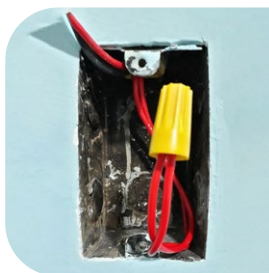
Uso do conector em uma caixa de passagem da instalação
