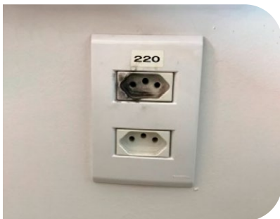
Furo da tomada com aparência de sobrecarga e aquecimento
