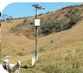
Rede com transformador
