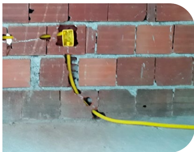
Eletroduto embutido na parede
