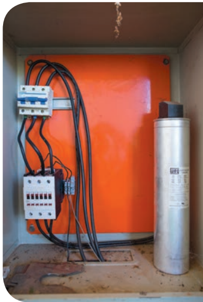
Capacitor do transformador
