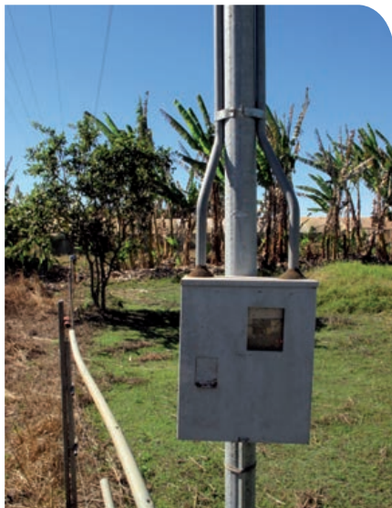
Instalação elétrica bem feita
