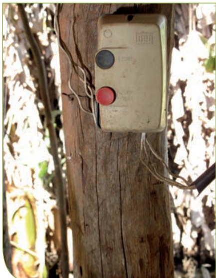
Instalação elétrica mal feita
